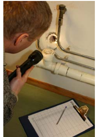
Bygningen inspiseres og hull og sprekker som dyr kan komme gjennom må tettes (Foto: H. Heggen, Folkehelseinstituttet)
